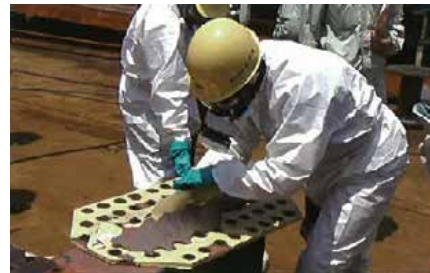
加熱後の塗膜剥離状況
