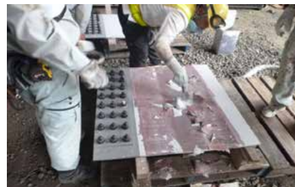
加熱後の塗膜剥離状況
